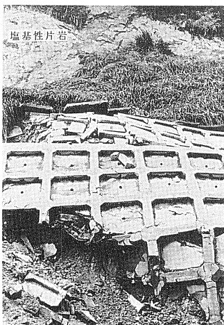
写真-3 宇部(A)での斜面Ⅴの崩壊状況
