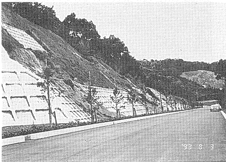
写真-1 宇部(A)での斜面の崩壊状況の一部
