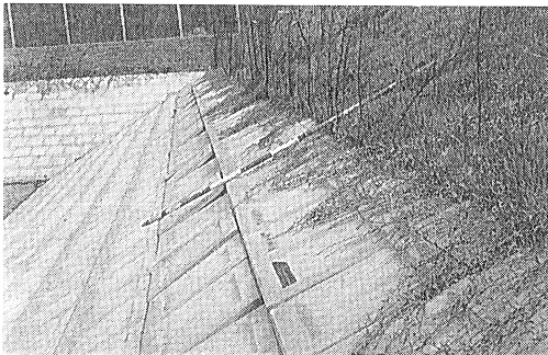
写真－1 張ブロック（50×50cm）の変状
