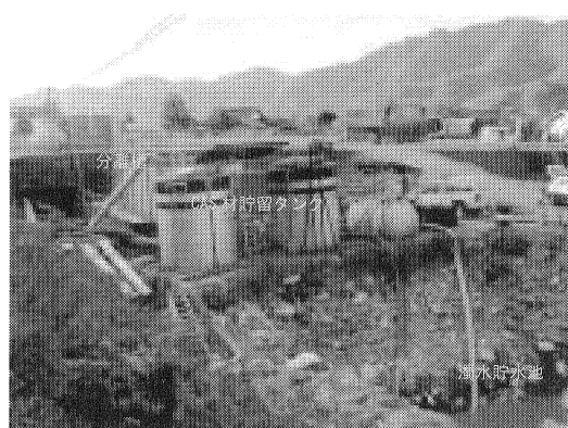
写真-7 D 地区工事濁水処理設備
