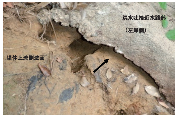
図-18 洪水吐境界部のパイピングホール
