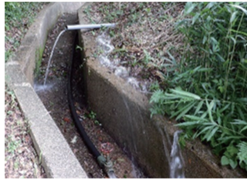
図-16 漏水量の増加
