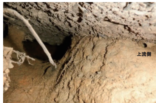
図-19 洪水吐下面の空洞 （図-18 矢印方向に撮影）
