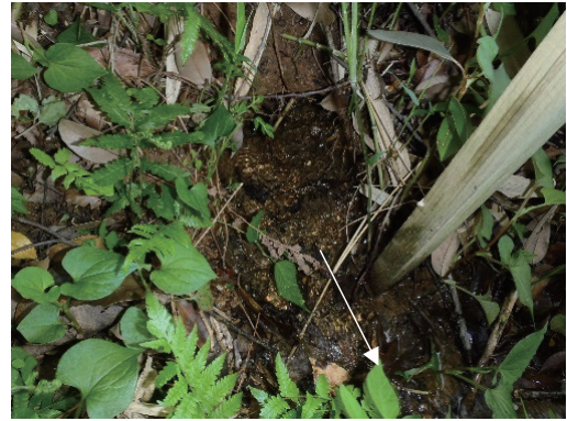
図-6 2016.5.30 (水土里ネットしまね提供) 下流法面の漏水漏出部
