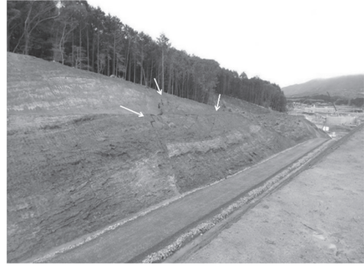
写真-1 亀裂発生直後
