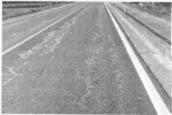
写真-3 老化ひび割れ路面
