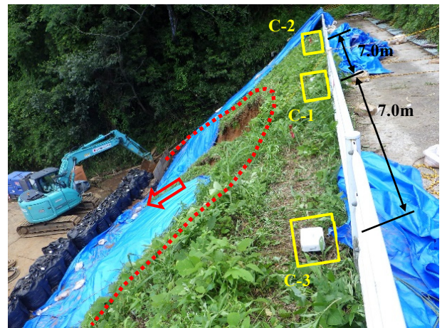
写真-2 崩壊全景
